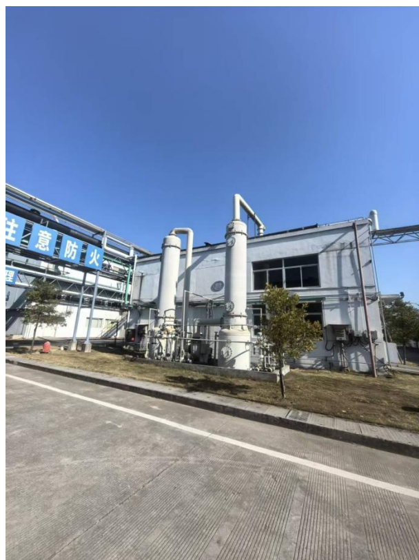
三光气库和甲类危废仓库废气预处理设施
