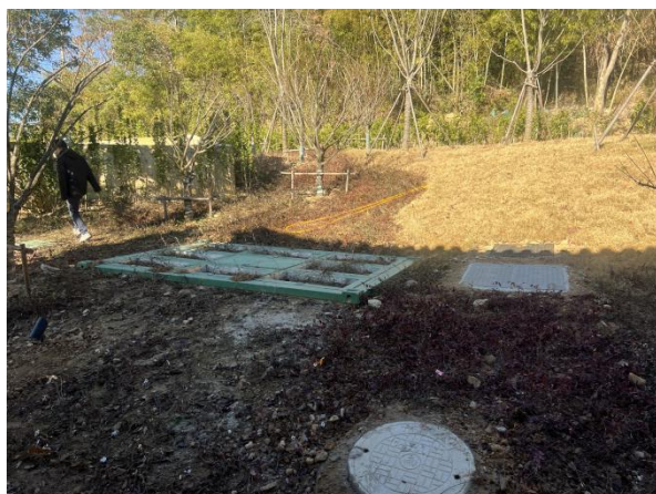
废水处理设施
