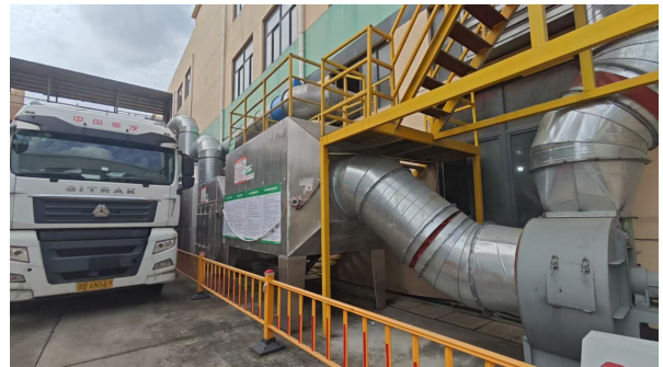
水喷淋+除雾器+三效过滤器+活性炭吸附 (TA004)
