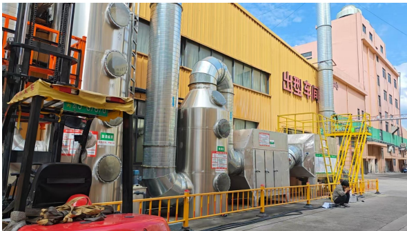
水喷淋+除雾器+三效过滤器+活性炭吸附 (TA003)
