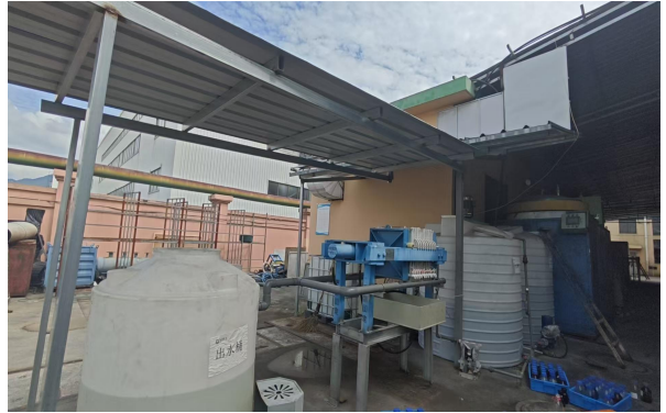
废水处理设施
