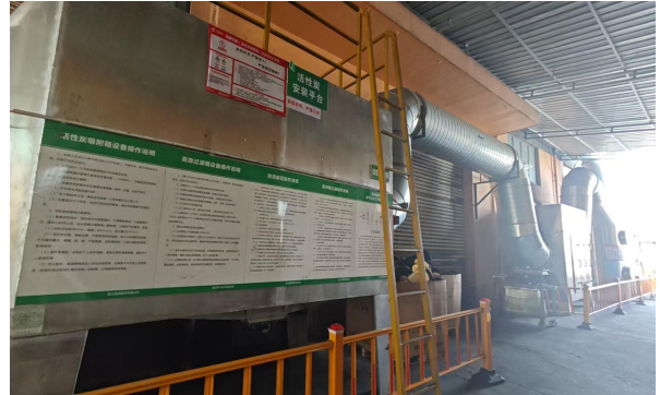
布袋除尘+水喷淋+除雾器+三效过滤器+活性炭吸附 (TA002)
