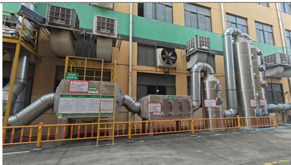
水喷淋+除雾器+三效过滤器+活性炭吸附 (TA005)
