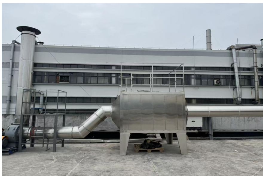
活性炭吸附+排气筒
