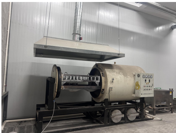
真空煅烧炉废气收集
