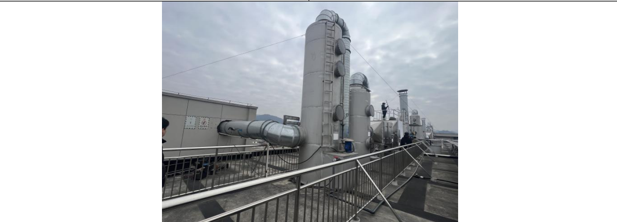
废气处理设施
