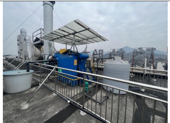
废水处理设施
