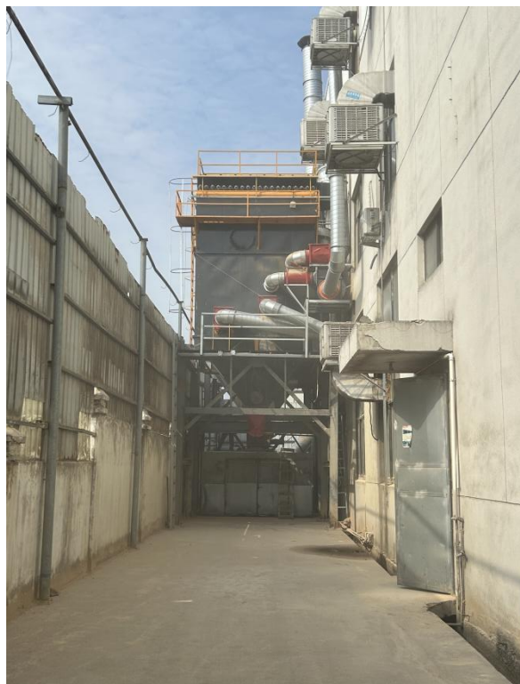
造型、打孔、打磨粉尘处理设施
