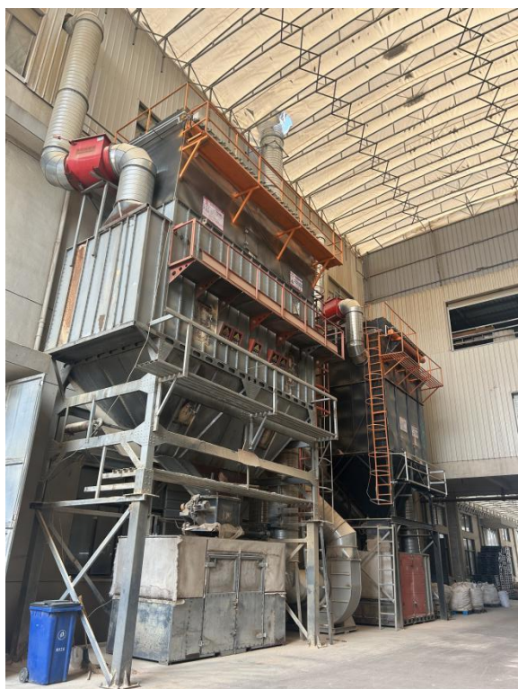
开料、下料、抛光、植毛粉尘处理设施
