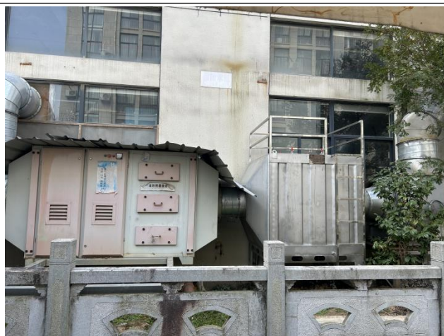
注塑废气处理设施
