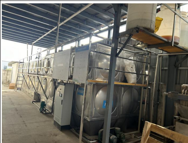
废水处理设施（混凝+生化）
