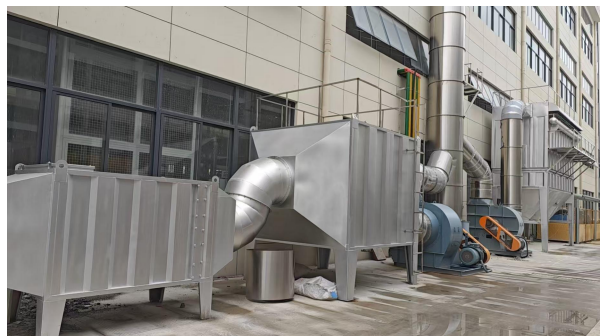
布袋除尘装置和“干式过滤+活性炭吸附”装置
