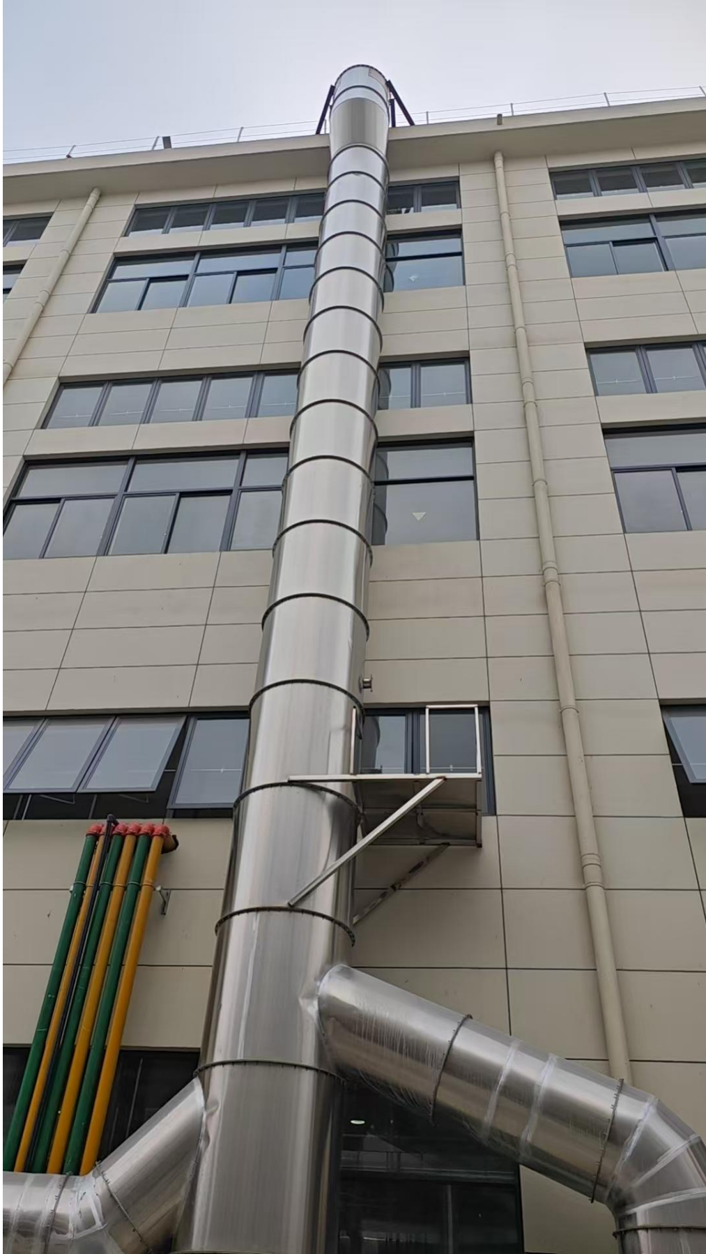
排气筒+采样平台
