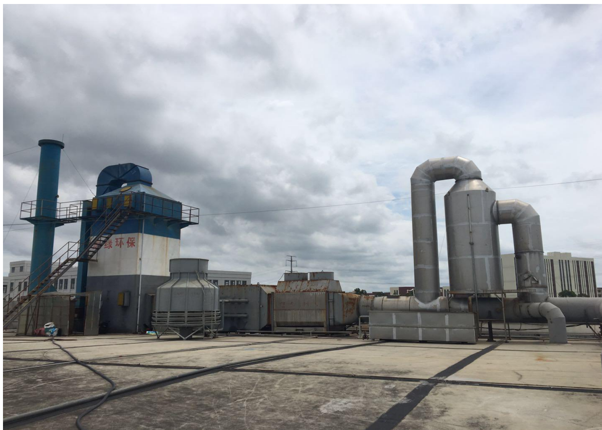
定型废气处理设施
